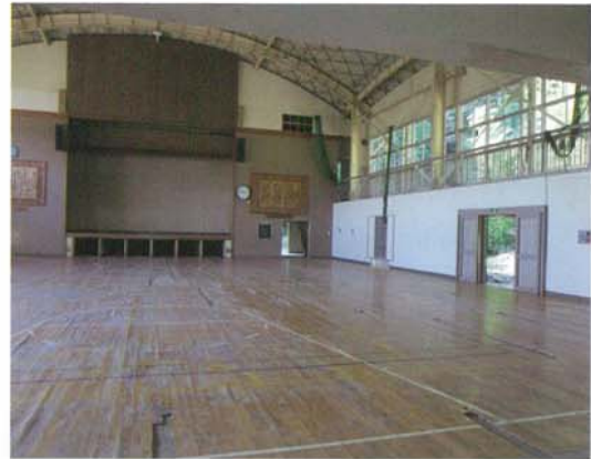
▲野蒜小学校体育館。床は浸水したときの傷跡が今もそのまま残されています。(写真8)
