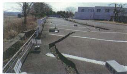
▲キャンパス南側の地割れと地盤沈下
